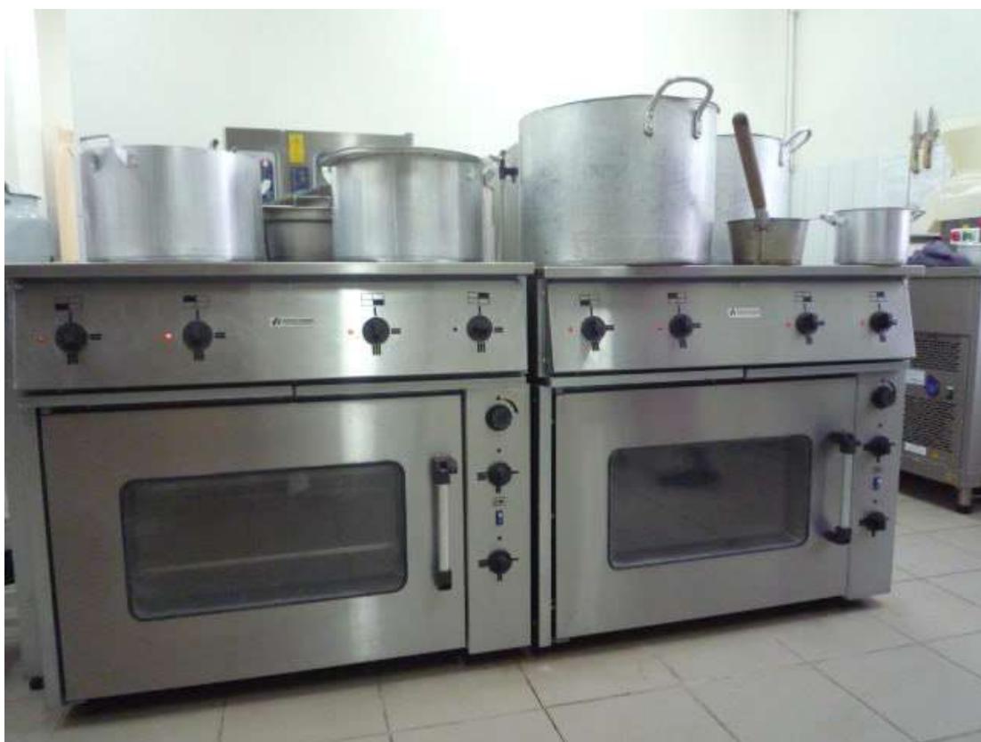
электрические плиты с жарочным шкафом
